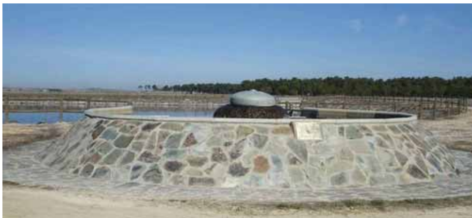
Figura s-2 c). Cabecera del dispositivo de recarga artificial (hongo) durante el ciclo y en el período invernal con la válvula de entrada cerrada.
